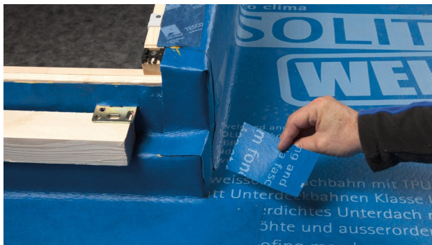
27. Snijd een klein stuk SOLITEX WELDANO 3000 uit om de lassen bij de onderste hoek te bedekken.
