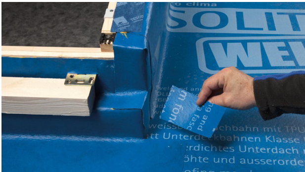
27. Um Schnittkanten im unteren Eckbereich zu überdecken, einen kleinen Streifen SOLITEX WELDANO 3000 ausschneiden und anlegen.
