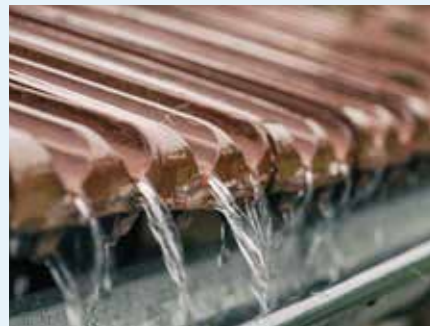
Abb. 7: Witterungsschutz des fertigen Daches wird hauptsächlich durch die Eindeckung erzeugt. Dennoch kann Wasser z. B. bei Schlagregen hindurchtreten.
