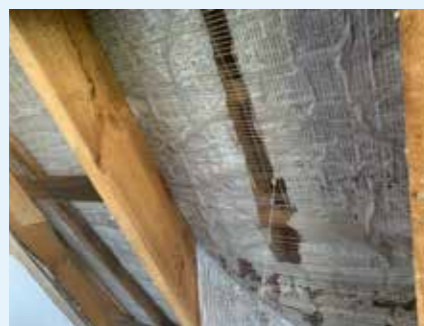
Abb. 13: Alte zerstörte Unterspannbahn (sog. »Gitterfolie«) – die Ausgasung flüchtiger Weichmacher führte zu starker Versprödung
