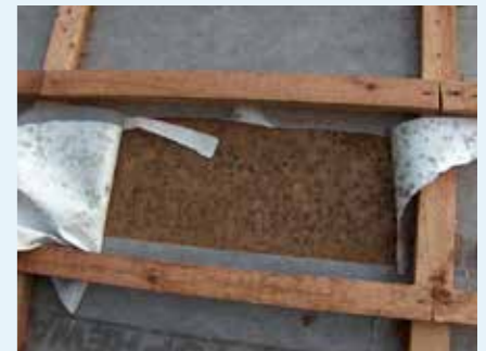
Abb. 31: Schimmelbefall unter mikroporöser Unterdeckbahn - aufgrund von schwachem, passiven Feuchtetransport hat sich die Holzfaserverplatte unterhalb der Bahn aufgefuechtet und Schimmelwachstum begünstigt
