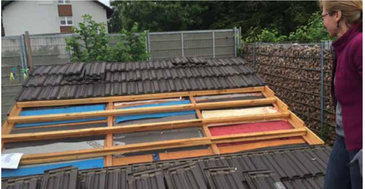
Untersuchung von frei gespannten Unterdach- bzw. Unterdeckbahnen verschiedener Hersteller 5 Jahre nach dem Einbau
