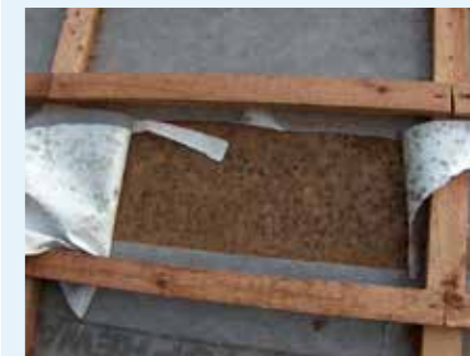
Abb. 31: Schimmelbefall unter mikroporöser Unterdeckbahn – aufgrund von schwachem, passiven Feuchtetransport hat sich die Holzfaserverplatte unterhalb der Bahn aufgefuechtet und Schimmelwachstum begünstigt
