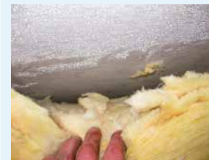
Abb. 30: Wasserfilmbildung bei mikroporöser Unterdeckbahn
