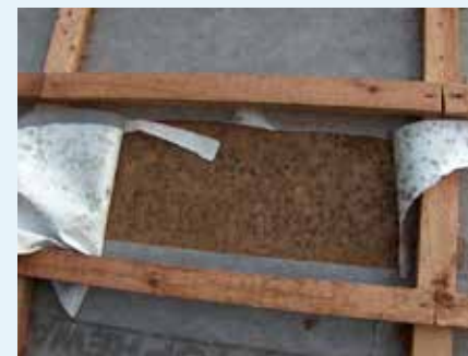
Afb. 30: Schimmelvorming onder microporeuze dakfolie – vanwege zwak, passief vochttransport is de houtvezelplaat onder de folie vochtig geworden, waardoor schimmelvorming werd bevorderd.
