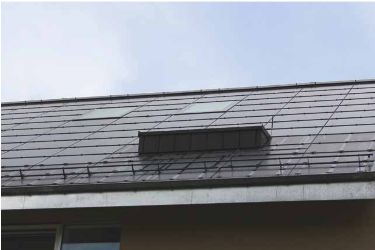
Integrierte PV-Anlage mit Unterdach SOLITEX MENTO 3000 connect
