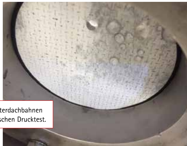
Weitere marktübliche Unterdachbahn. Nach fünf Jahren natürlicher Alterung ist die Unterdachbahn bereits ohne Druckbeaufschlagung undicht.
