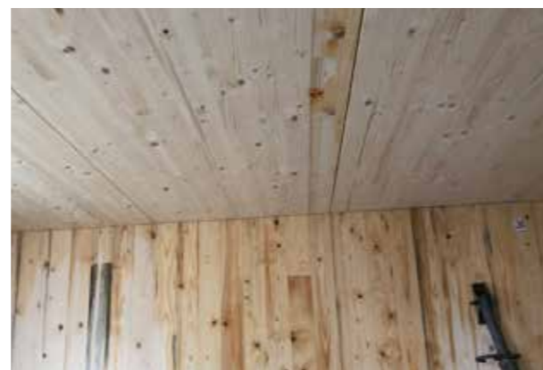
Unschöne Wasserflecken an einer Brettsperholzdecke
