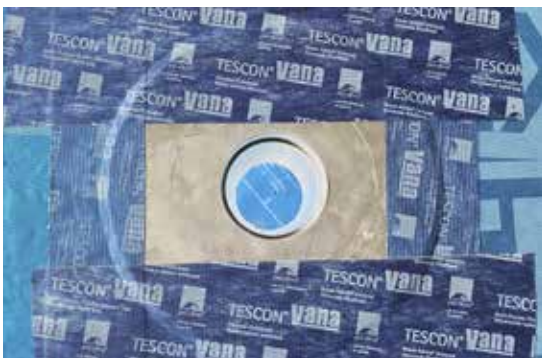
Zum Anschluss von Gullys zur Flächenentwässerung an SOLITEX ADHERO.
