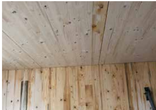
Unschöne Wasserflecken an einer Brettsperrholzdecke
