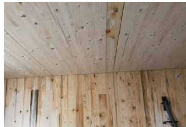
Unschöne Wasserflecken an einer Brettspertholzdecke
