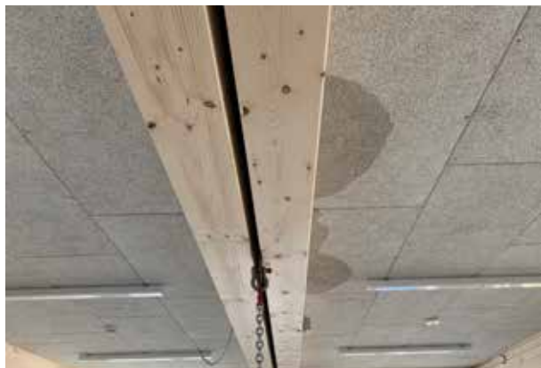
Lekkage tussen twee bouwelementen
