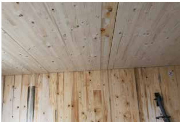
Lelijke watervlekken op een CLT-plafond
